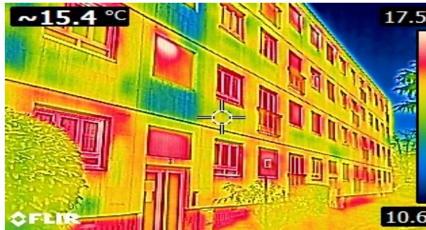
Déperdition au droit des séchoirs
